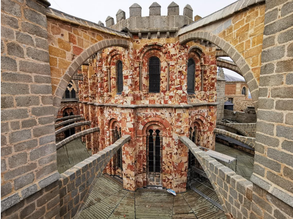
Distintas variedades de roca granítica en la parte superior del cimorro de la catedral de Ávila.
