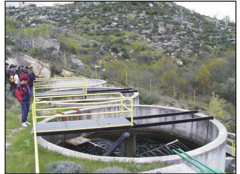
Figura 15: EDAR de El Berrueco.
